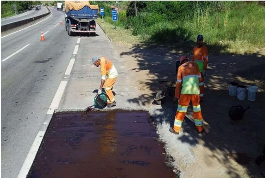
FOTO 01- Acostamento - Rep Superficial - KM 14+000 Norte [1]
