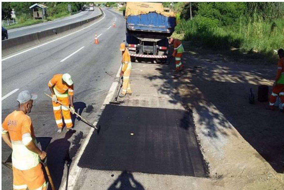
FOTO 02- Acostamento - Rep Superficial - KM 14+000 Norte [2]
